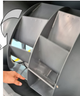
3.- Continuar con la inyección de grasa y al mismo tiempo girar el rodete para lograr una inyección uniforme en la pista interna del rodamiento
